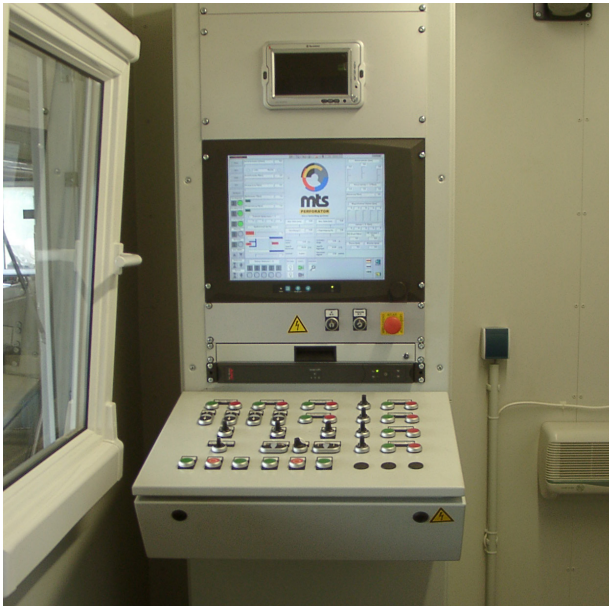
Blick in den Vortriebscontainer mit dem Steuercomputer.
